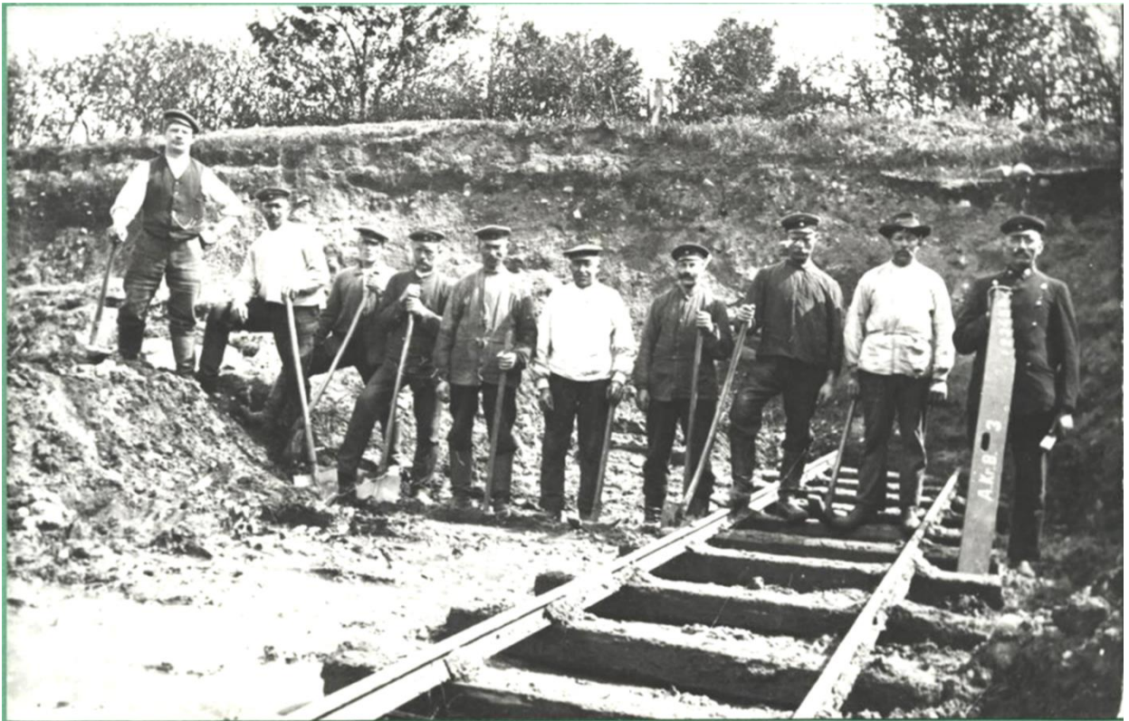
Grusgrav ved Ketting. Lok nr. 1 blev indsat på anlægsarbejdet 27. august 1897, det hentede bl.a. grus i denne grusbakke ved Ketting. Det første spadestik til banen blev taget den 28. september 1896.
